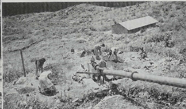
杉本君、向井君も村の若者たちとともにパワーハウス 基礎工事に汗を流す（半ズボンの2人）
